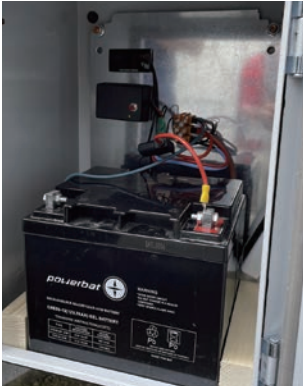
照明用パワーユニット
